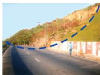
Figura 3.9 – Deslizamento circular ou rotacional.
